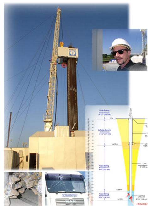
Thermalwasserbohrung Bad Wörishofen GT2
